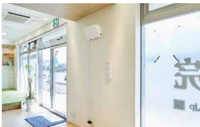
▲ 虫の飛来ポイントであるエントランス付近の壁面に設置。「捕虫器」と感じさせず、インテリアに溶け込んでいる。
