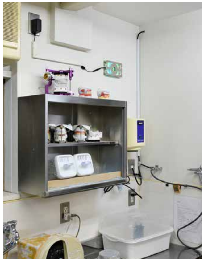
▲ 換気扇も虫の侵入経路の一つ。 この作業エリアでは「ルーチ・虫とら」を使用
